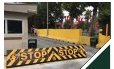
Yol Kapanları Road Blocks
